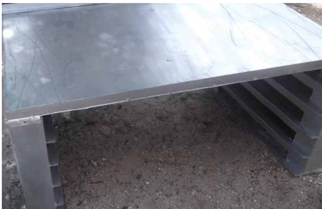
43 - Couvercle métallique reliant les deux caissons
